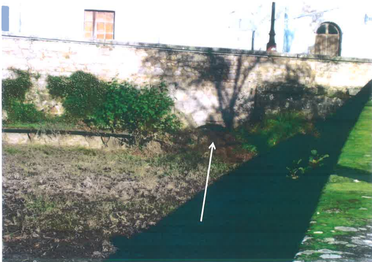
- bief du moulin ensablé, présence de boue, de végétation -
